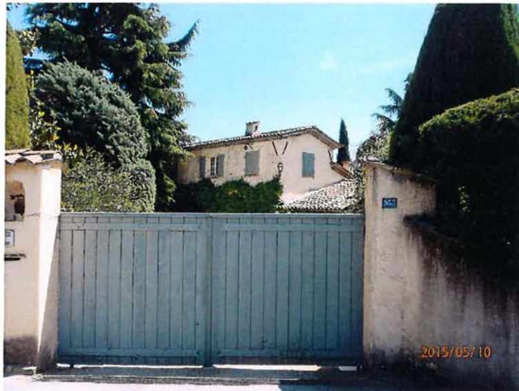
Photo n°11 : maison fissurée rue du Puits du Plans Indice de déformation du sol
