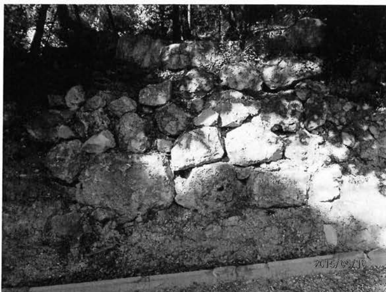
Photo n°6 : muret aux pierres déchaussées sur le chemin des Adrets
