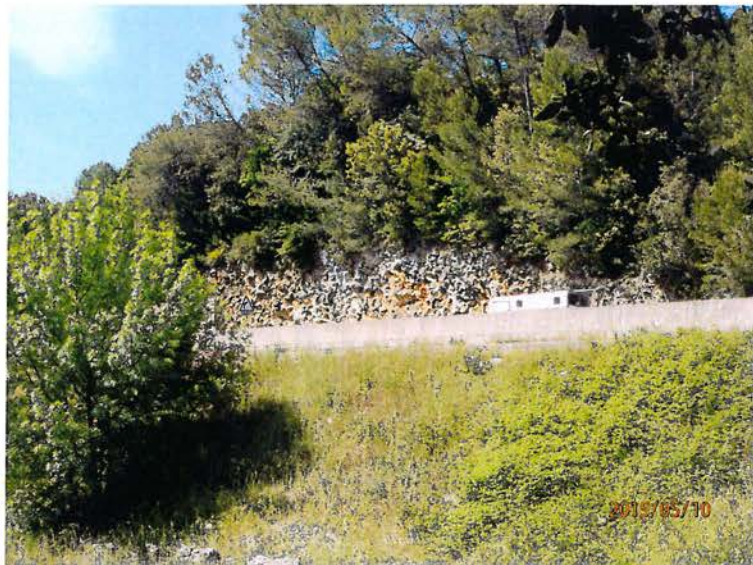
Photo n°12 : zone à chute de blocs possibles le long du vallon de Tiragon
