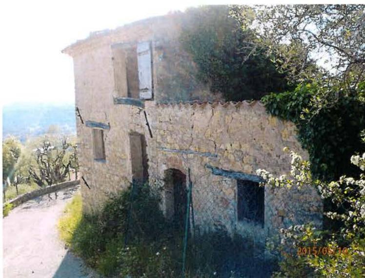
Photo n° 7 : maison fissurée dans le quartier de la Tour de Laure
